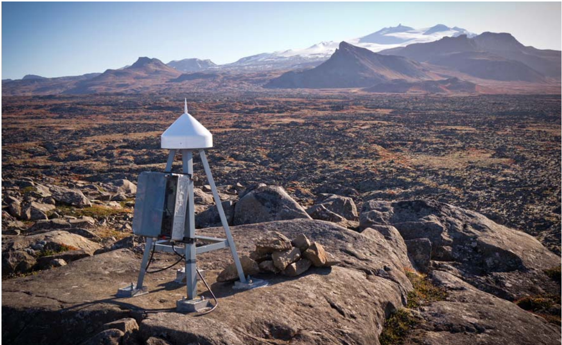
Ný GPS/GNSS jarðstöð á Snæfellsnesi.
